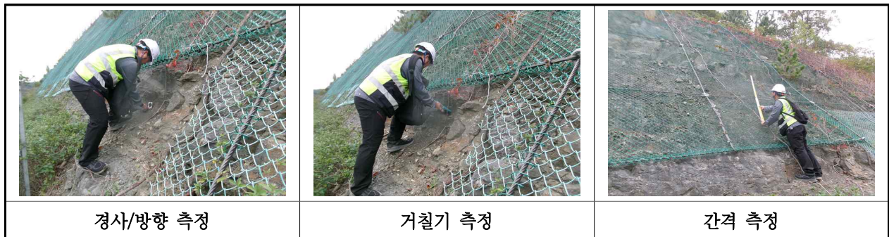
【사진 30.3.2】 불연속면 측정 현황
